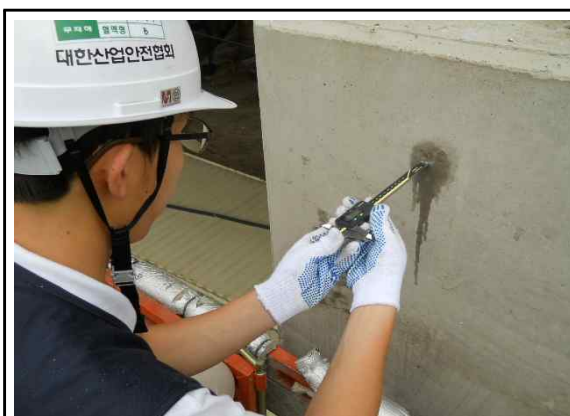
교각 코핑부 탄산화 시험
