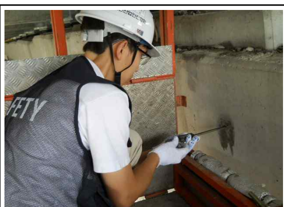
교각 코핑부 탄산화 시험
